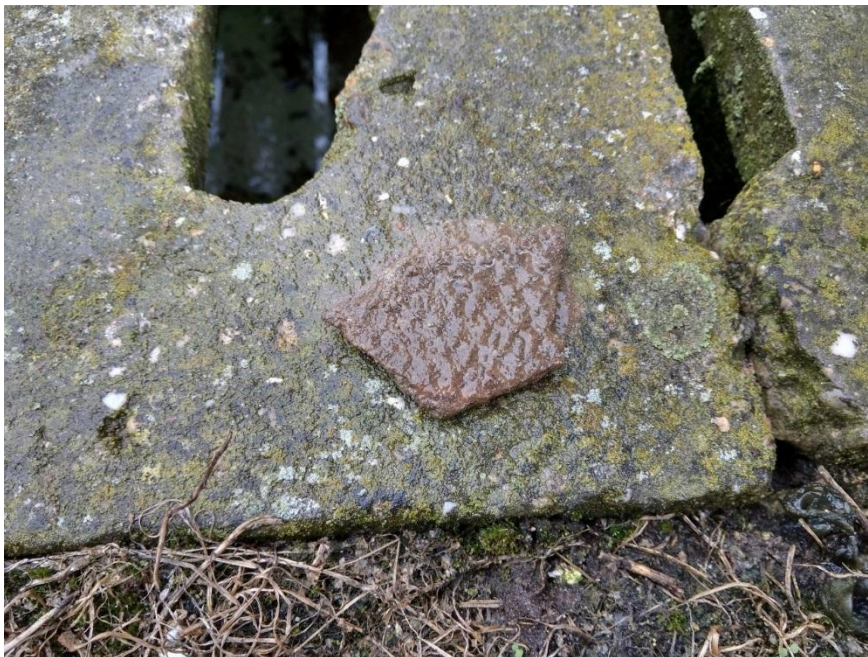
Afbeelding: Asbestmateriaal ter plaatse van C07S
