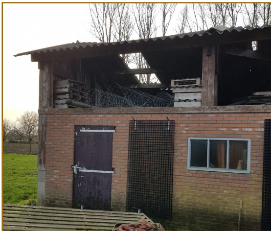
Afb. 2.9: Een foto van de buitenkant van de schuur met nummer 6. De zijkant is voor een groot deel open en ook missen een paar dakplaten waardoor er veel licht binnenkomt.
