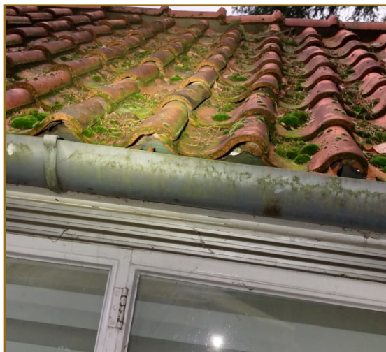
Afbeelding. 2.11: Dakpannen van recreatiewoning 34.
