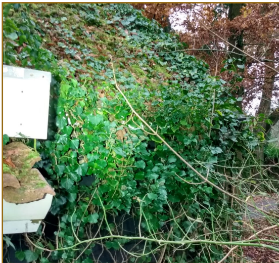
Afbeelding. 2.9: Klimop over de rand van de dakpannen bij recreatiewoning 35.
