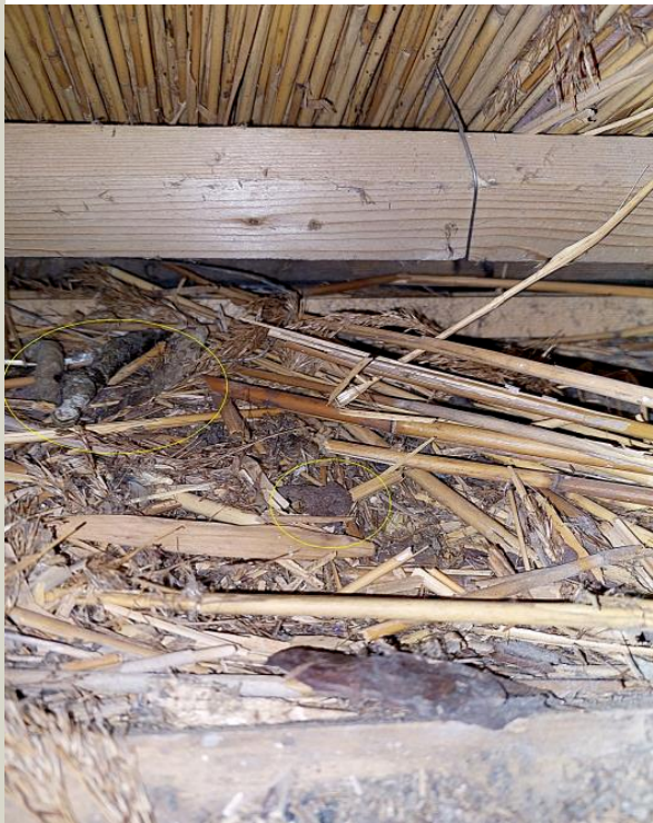
Woning: steenmarterpoep (markeringen)
