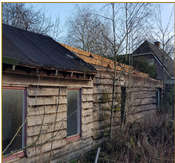
Afbeelding 2.12: De zuidelijke kant van gebouw 6. De dakbedekking is deels weg waardoor dat deel van het gebouw erg licht en tochtig is.
