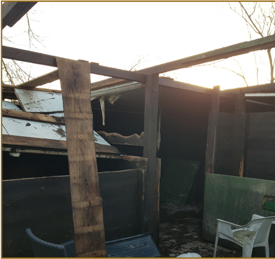
Afbeelding 2.7: Binnenkant van gebouw 4. De dakbedekking is weg en daarom is de schuur erg licht en tochtig.
