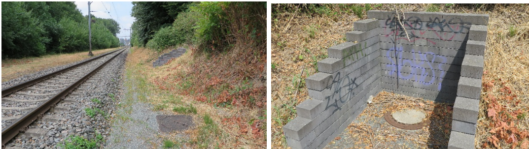
Figuur 3-1 Infiltratieputten tussen spoor km 19.2 en 19.4
