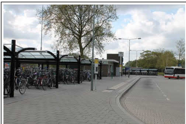
Bustation aan achterzijde station (olievlekken op straatwerk)
