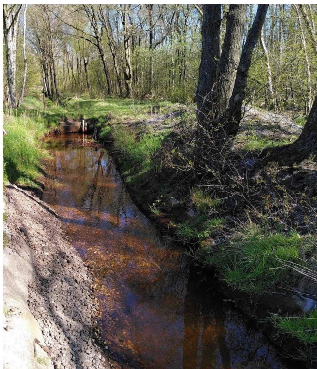
Figuur 10: De lekkende naden van de bentonietmatten zijn inmiddels gedicht door plaatselijk een extra mat aan te brengen en deze te verzwaren met wat grind.
