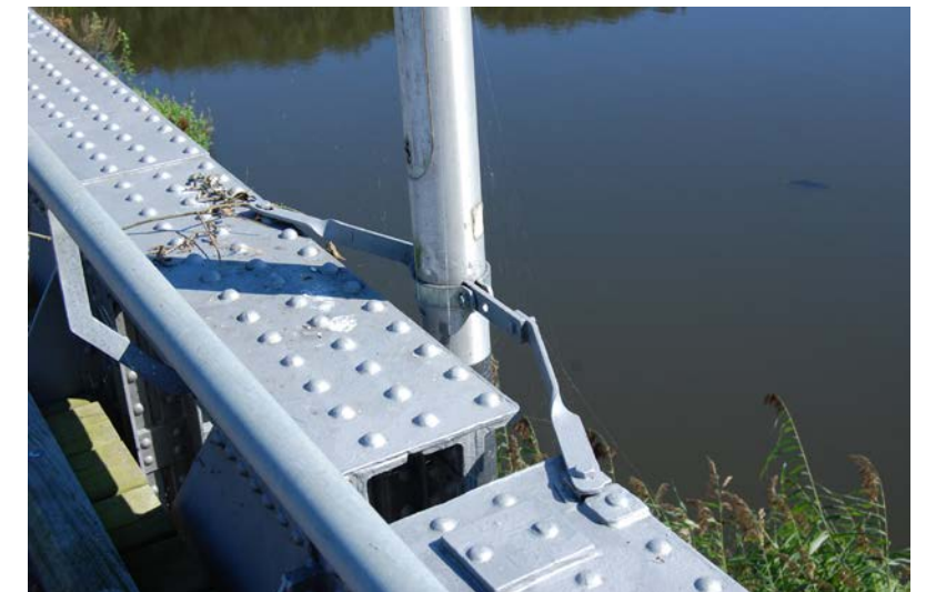
BEVESTIGING LICHTMAST AAN SPOORBRUG
