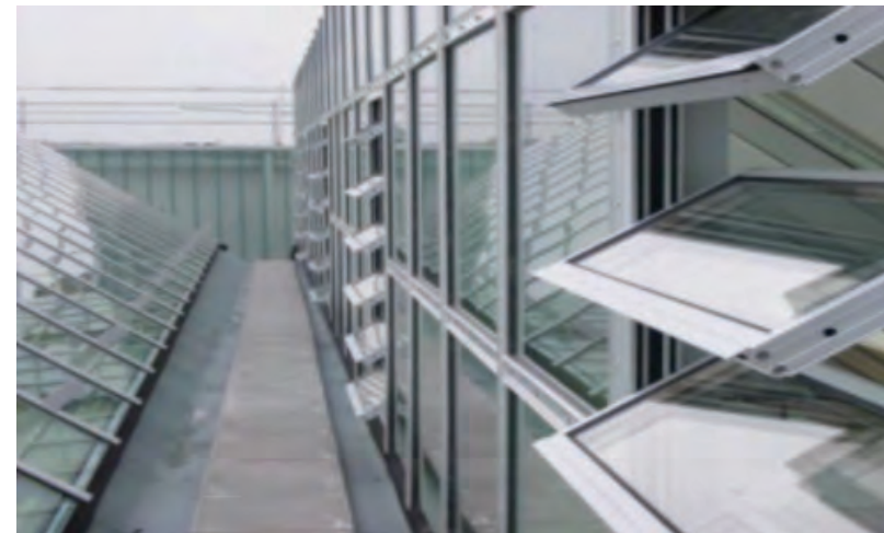
S.AIR , natuurlijke ventilatie in sheddaken
