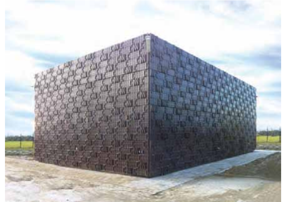
Gasontvangststation Dinteloord, SMV
