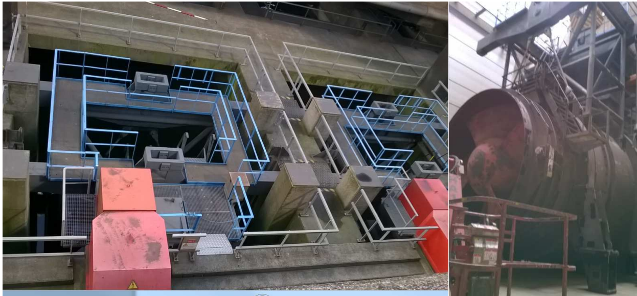
Figuur 10: bovenaanzicht pompschachten met aandrijfunits (rood) (links) en pomp in onderhoud (rechts)
