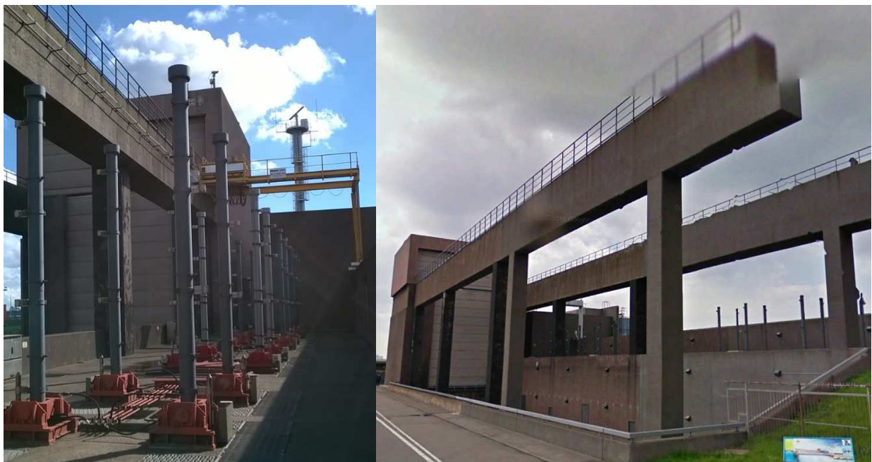
Figuur 11: cilinders voor open/sluiten van waterkerende schuiven van het Gemaal (links) kraanbaan portalen (rechts)
