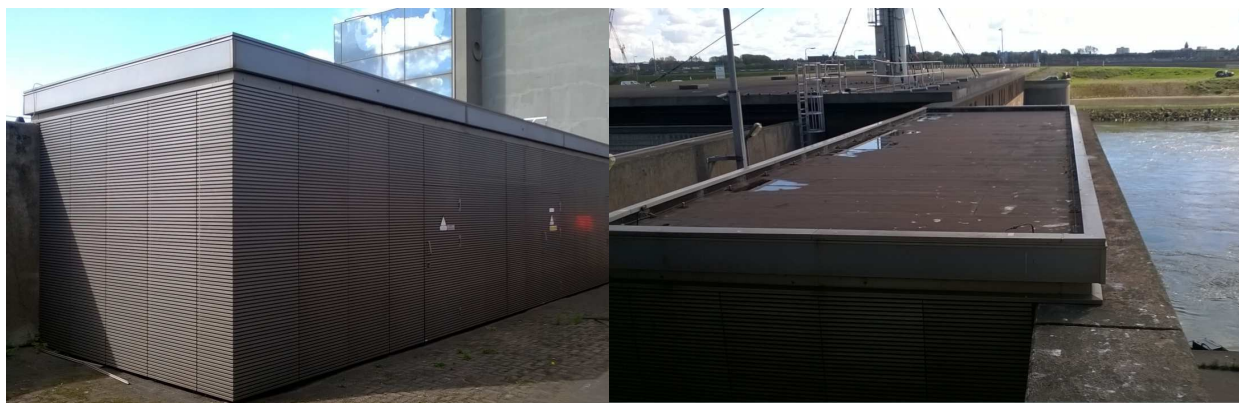
Figuur 5: transformatorstations bij Spuisluis
