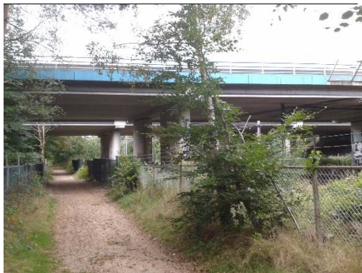
Figuur 3.6 Faunapassage ten zuiden van het spoor
