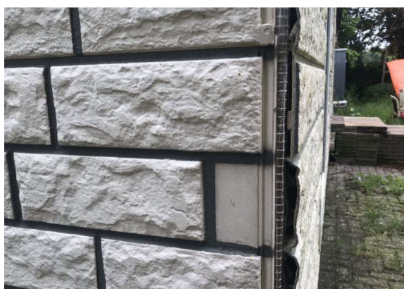
Figuur 9. De woonwagens bestaan uit plaatmateriaal, wat niet isoleert, waar achter het heet wordt en waar vleermuizen geen houvast hebben.
