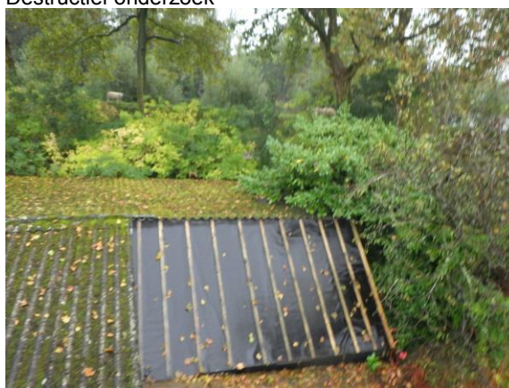
Asbesthoudende golfplaten, bedrijfsruimte
