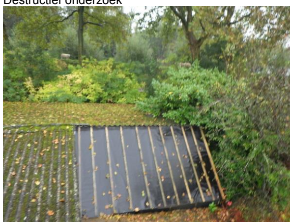
Asbesthoudende golfplaten, bedrijfsruimte
