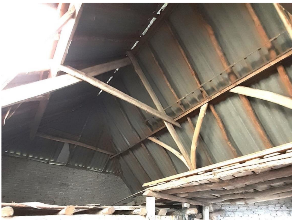
Dak van schuur 1 met asbestgolfplaten
