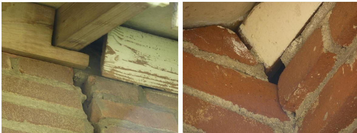
Enkele openingen onder de dakrand.
