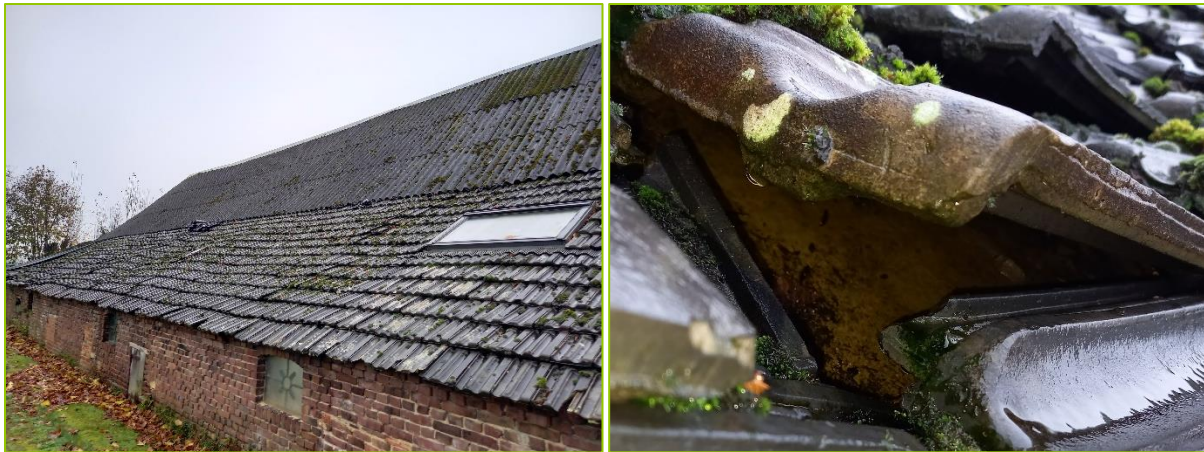
Figuur 2 Het lage pannendak met losliggende pannen (links) en een opgelichte losliggende dakpan (rechts).
