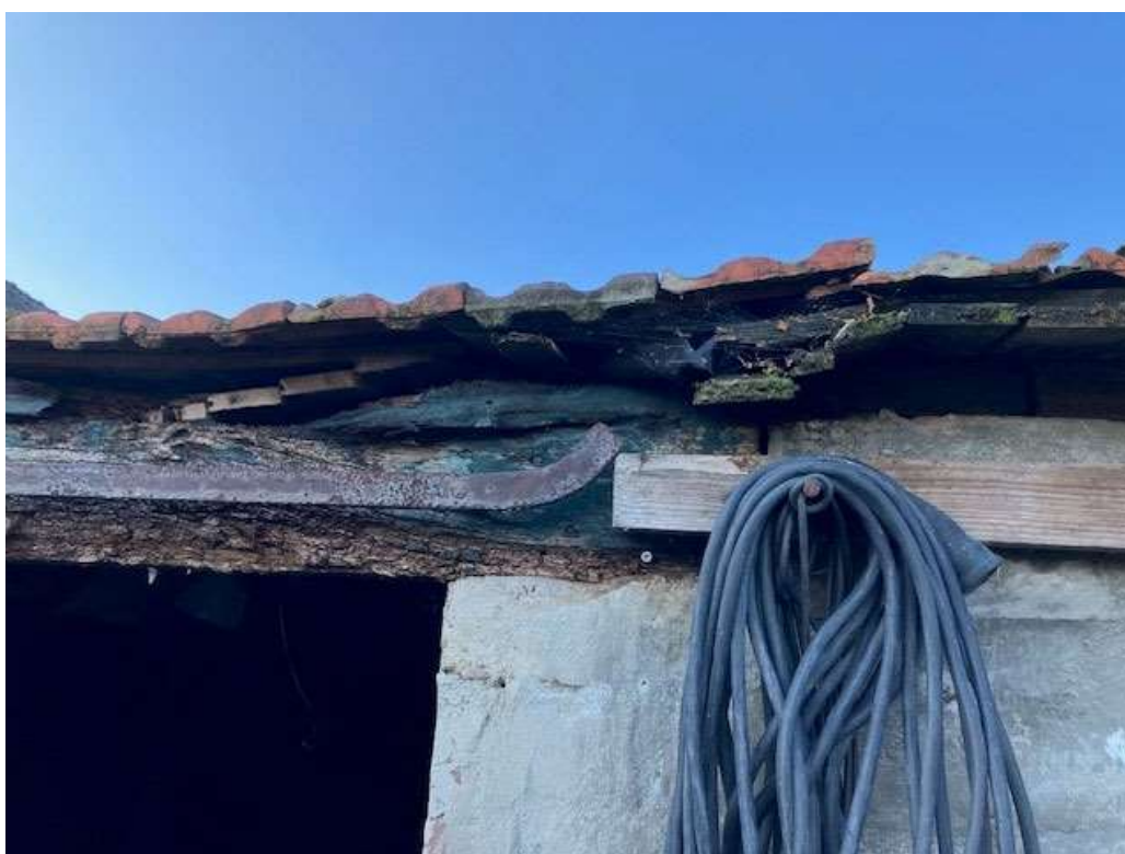
• Afbeelding 7: onderzijde pannendak met dakbeschot, dakbeschot heeft rotte plekken door lekkages
