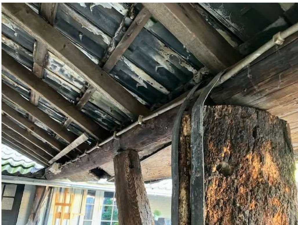
• Afbeelding 6: Onderzijde dak gebouw 1, geen dakbeschot
