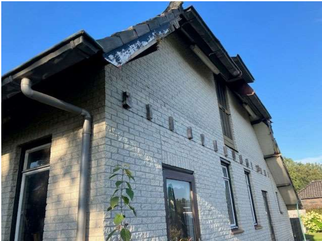
• Afbeelding 14: Achterzijde te verbouwen koetshuis/schuur, tl balken onder het overstek
