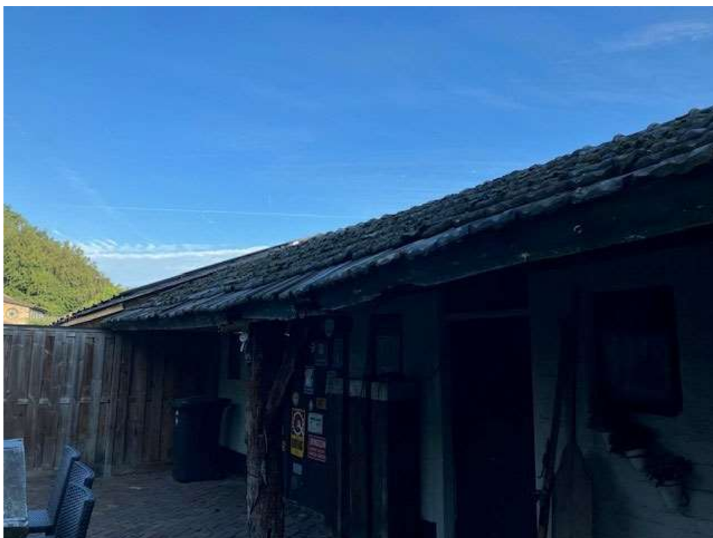
• Afbeelding 4: Gebouw 1 pannendak niet voorzien van dakgoot
