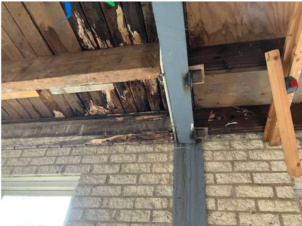
• Afbeelding 17: Lekkages in de schuur
