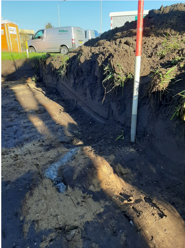
0,4 m-mv restanten puin
