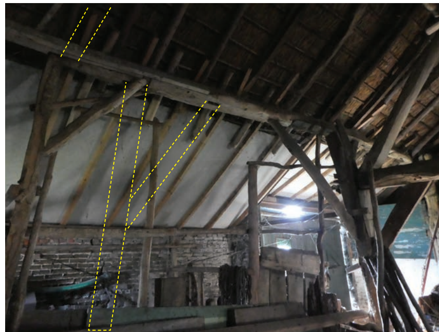
Gebintplaat en stijl op C8. In geel de oude locaties van stijl, schoor en eindplaat.
