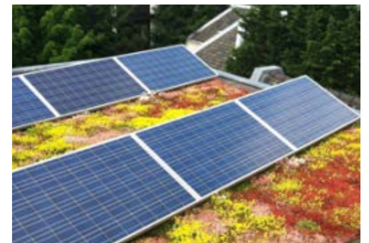
Zonnepanelen gecombineerd met sedumdak
