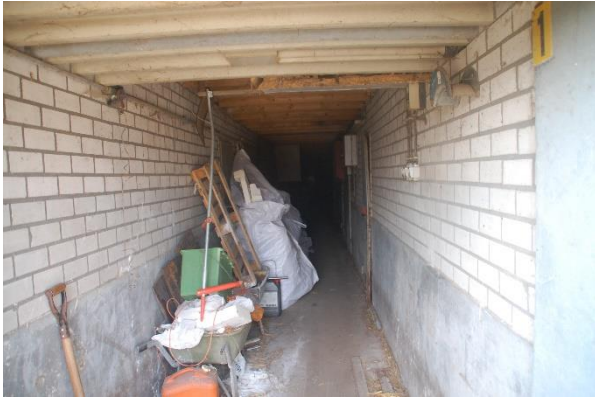
Afbeelding: binnenzijde varkensstallen
