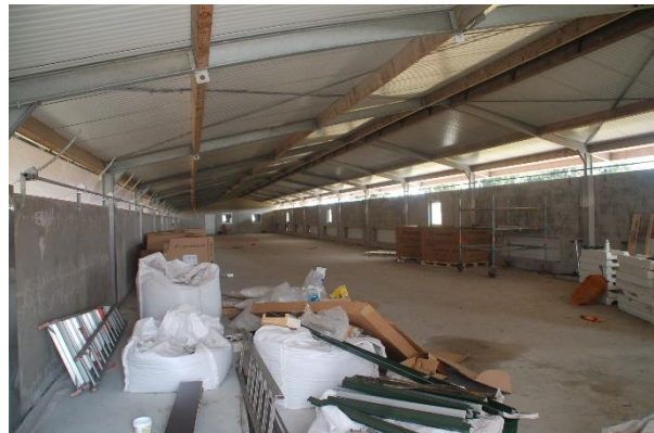
Afbeelding: binnenzijde kippenstal
