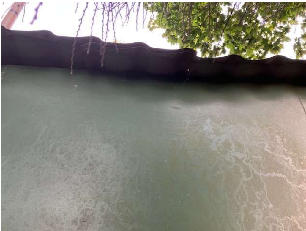
• Afbeelding 18: Bijgebouw is rot door vochtproblemen en heeft nauwelijks nog dakbedekking
