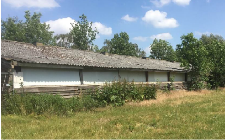
foto 3: stal met asbestverdachte golfplaten
