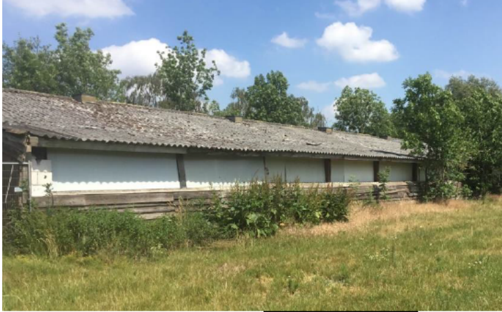
foto 3: stal met asbestverdachte golfplaten
