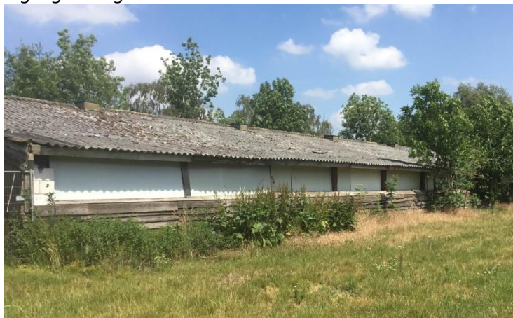
foto 3: stal met asbestverdachte golfplaten
