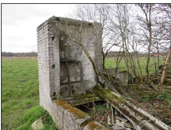
Foto 8. Bouwval van gebouw 5
