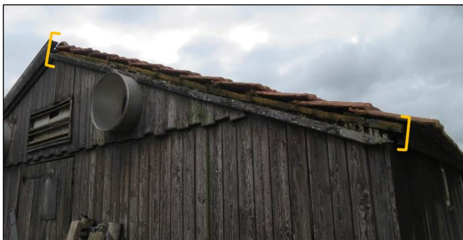
Foto 10. Door het ontbreken van betimmering is de ruimte tussen de dakpannen en het dakbeschoot toegankelijk voor vleermuizen
