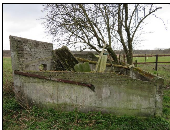
Foto 9. Bouwval van gebouw 6
