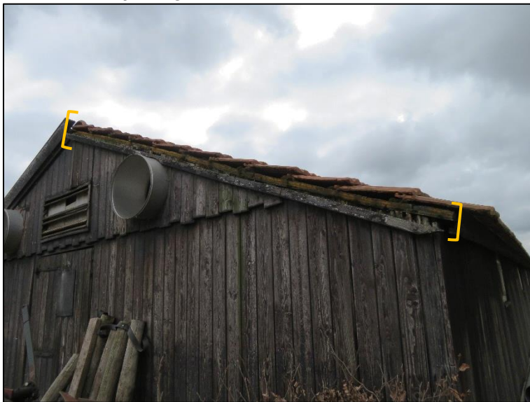
Foto 1. Door het ontbreken van de betimmering is toegang mogelijk tot de ruimte tussen de dakpannen en het dakbeschot
