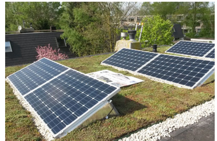
Zonnepanelen op plat groendak
