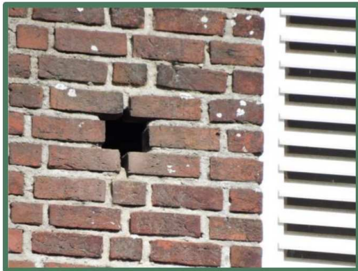
Afbeelding 28: Gat in de muur van 5.1.2e
