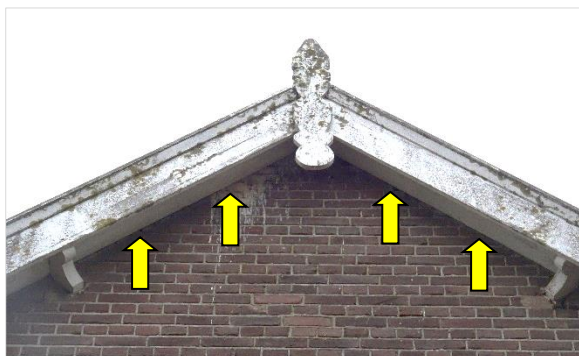
Figuur 5.3 Ruimte tussen gevel en dakbetimmering.
