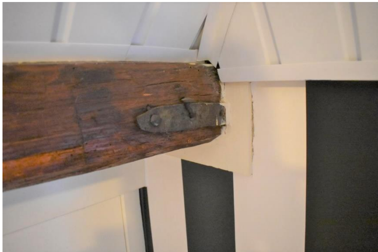
Smeedijzeren verankering van gebintplaat en metselwerk.
