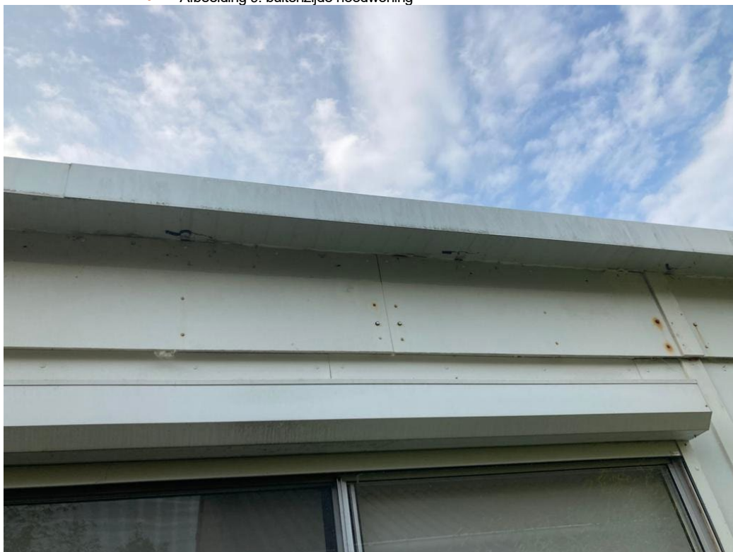
• Afbeelding 9: buitenzijde noodwoning
