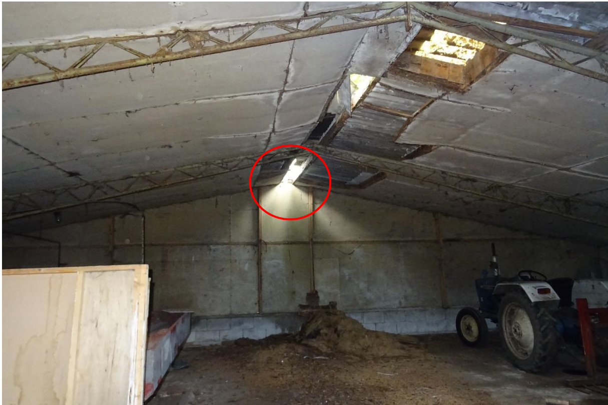
Afbeelding 9. Gat in de nok van het dak. Bron: R.J.L. Bijvelds 17-05-2021
