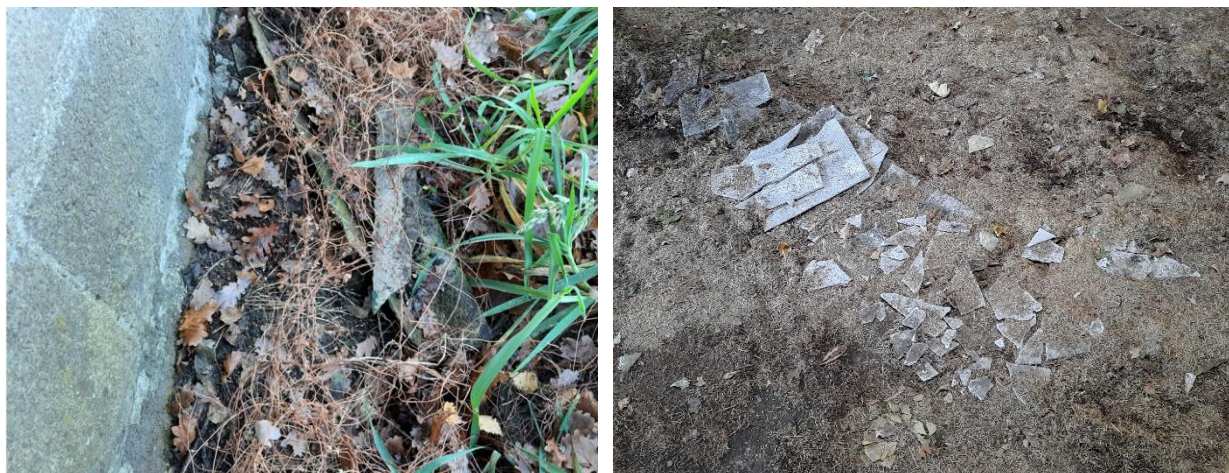
Afbeelding 2: foto asbestverdacht materiaal op maaiveld direct aan de oostzijde en inpandig van de veestal
