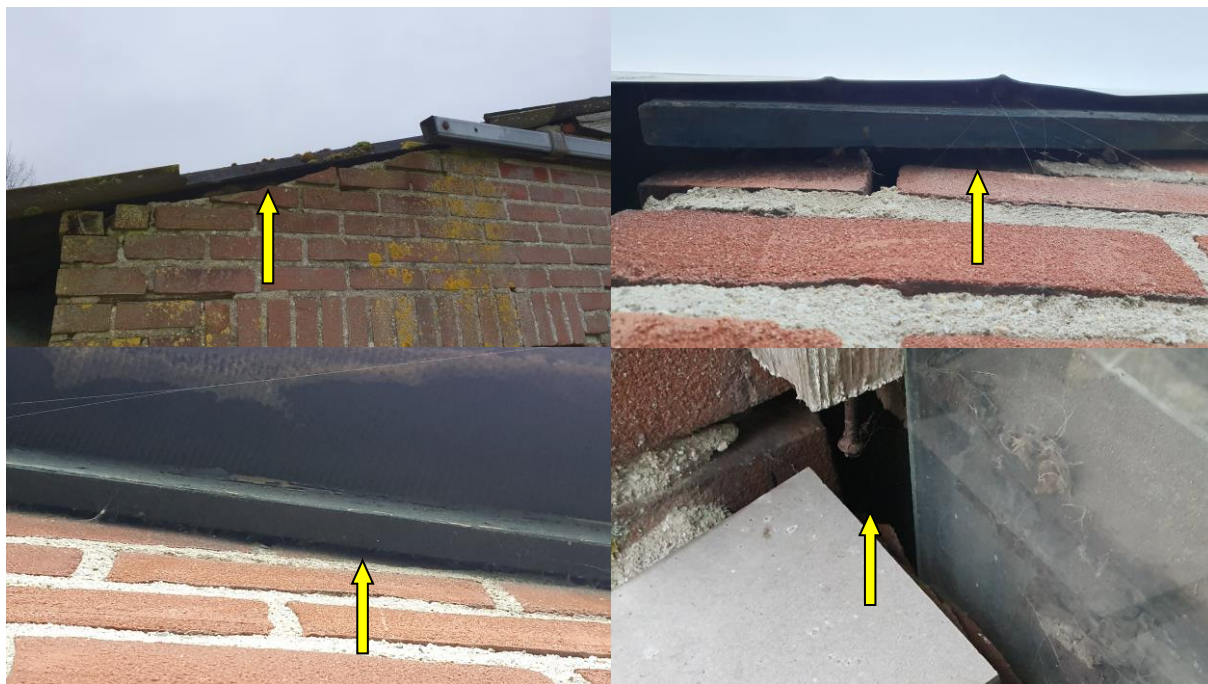
Figuur 4.4.3. De kopgevels en de ramen van de noordelijke schuur bevatten gaten en spleten waardoor vleermuizen de spouw kunnen bereiken.
