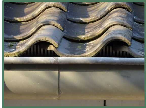
Foto 28: Vogelschroot onder eerste rij dakpannen.
