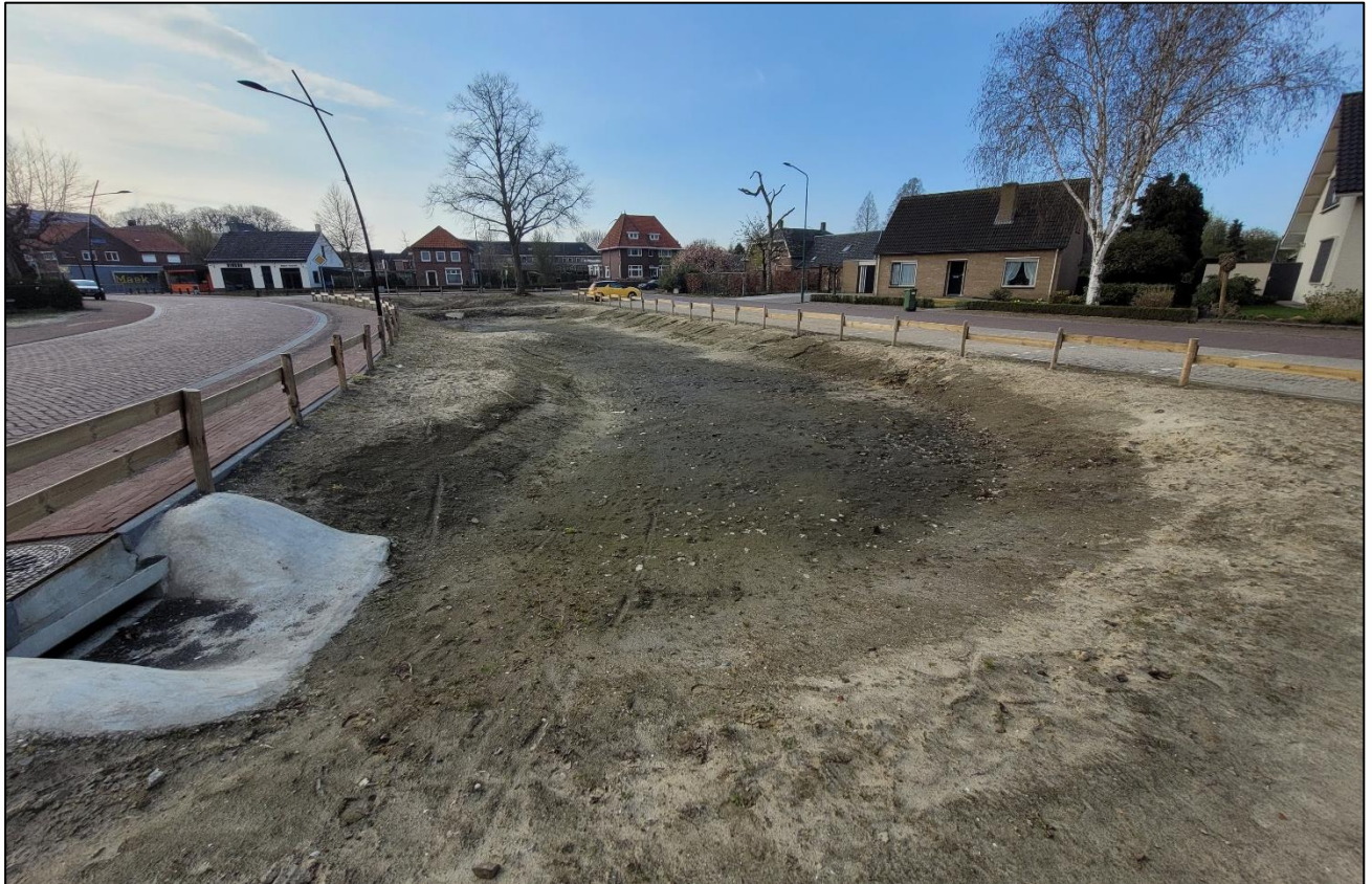
Figuur 9: Zicht op de wadi bij Breestraat 5, kijkend richting het zuidoosten (Foto: 14 april 2021).
