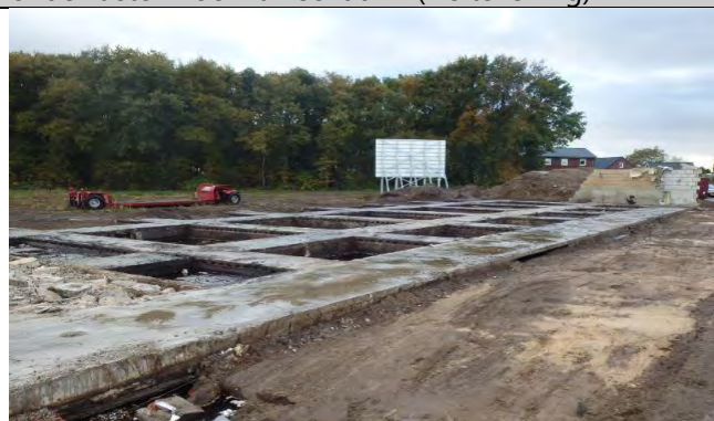
Foto nr. 2, Betonvloer is gedeeltelijk (helft) voorzien van ingestorte golfplaten onder de betonvloer van schuur 2, Identiek aan M 2 asbesthoudend
