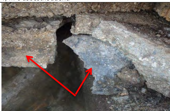
Foto nr. 6, Betonvloer is gedeeltelijk voorzien van ingestorte golfplaten onder de betonvloer van schuur 1, M 6 asbesthoudend
