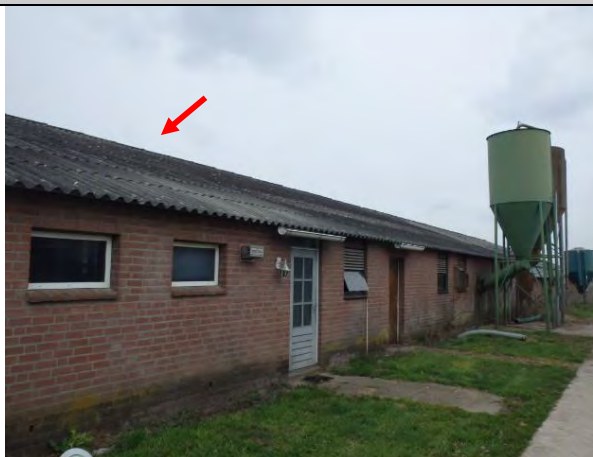
Foto nr. 3, Nokvorsten van schuur 1, M3, asbesthoudend
