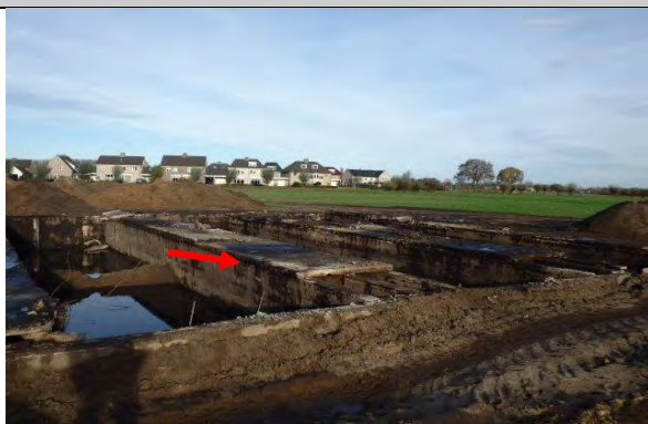
Foto nr. 4 Betonvloer is gedeeltelijk voorzien van ingestorte golfplaten onder de betonvloer van schuur 1, M 6 asbesthoudend
