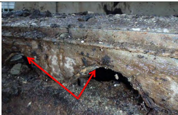
Foto nr. 3, Betonvloer is voorzien van ingestorte golfplaten onder de betonvloer van schuur 2, Identiek aan M 2 asbesthoudend
