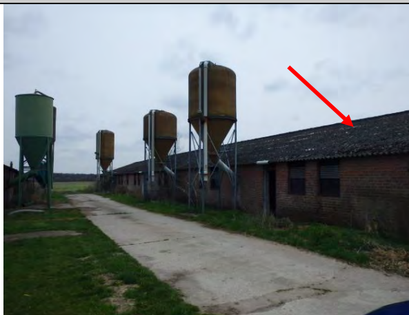
Foto nr. 4, golfplaten van schuur 2, als M2, asbesthoudend
