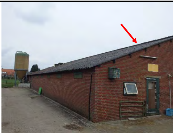
Foto nr. 6, nokvorsten van schuur 3, M 5, asbesthoudend
