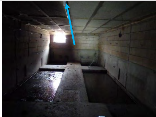
Foto nr. 9, plaat boven deur schuur 2 13 stuks M 1 geen asbest
