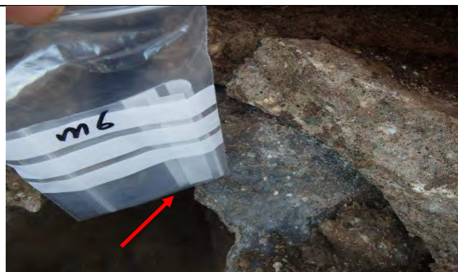
Foto nr. 7 Betonvloer is gedeeltelijk voorzien van ingestorte golfplaten onder de betonvloer van schuur 1, M 6 asbesthoudend
