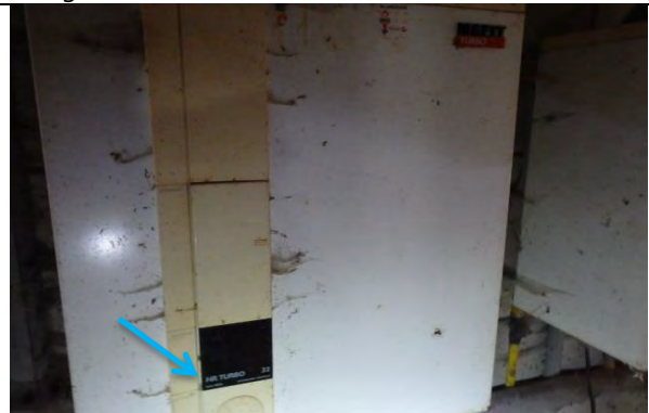
Foto nr. 12, HR CV ketels (4 stuks) geen asbest
