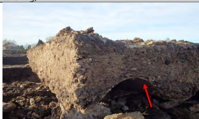
Foto nr. 5, Betonvloer is voorzien van ingestorte golfplaten onder de betonvloer van schuur 2, M 6 asbesthoudend
