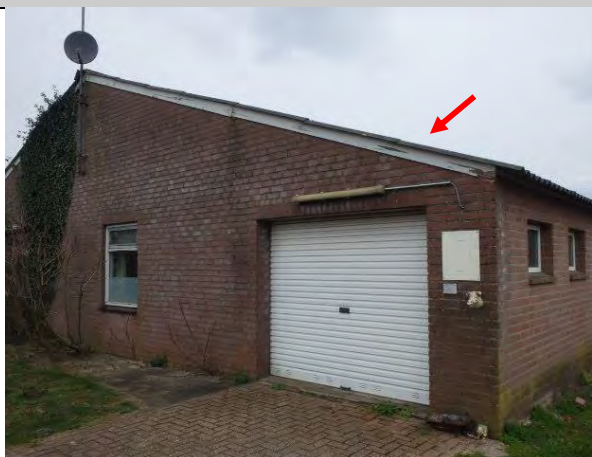
Foto nr. 1, Golfplaten van schuur 1, M2, asbesthoudend
