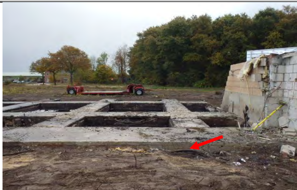
Foto nr. 1, Betonvloer is voorzien van ingestorte golfplaten onder de betonvloer van schuur 2, Identiek aan M 2 asbesthoudend
