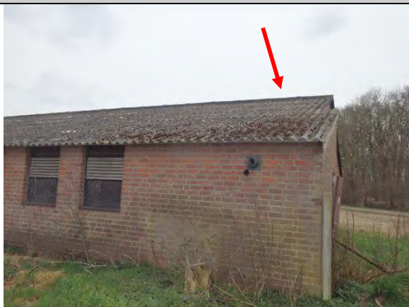
Foto nr. 5, Nokvorsten van schuur 2, identiek als M3, asbesthoudend
