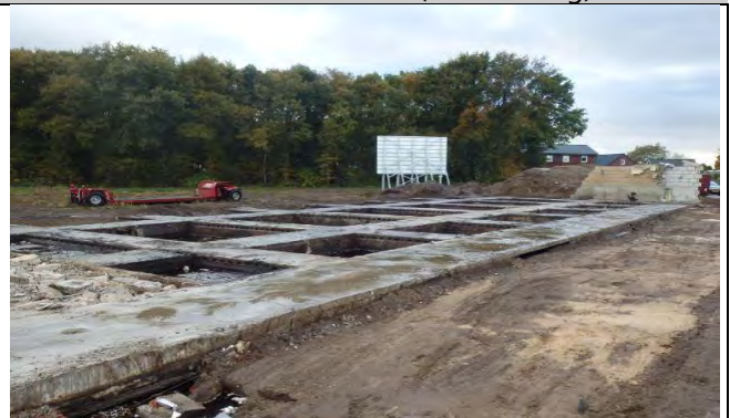
Foto nr. 2, Betonvloer is voorzien van ingestorte golfplaten onder de betonvloer van schuur 2, Identiek aan M 2 asbesthoudend
