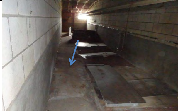
Foto nr. 18, schuur 2 vloer type B onderzoek benodigd
