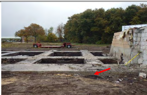
Foto nr. 1, Betonvloer is gedeeltelijk (helft) voorzien van ingestorte golfplaten onder de betonvloer van schuur 2, Identiek aan M 2 asbesthoudend
