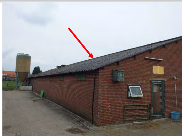
Foto nr. 8 Golfplaten van schuur 3, M4, asbesthoudend
