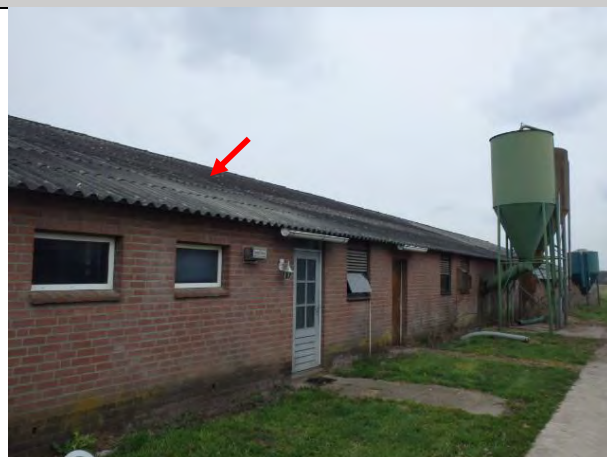
Foto nr. 2, Golfplaten van schuur 1, M2, asbesthoudend
