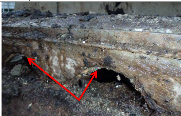
Foto nr. 3, Betonvloer is gedeeltelijk (helft) voorzien van ingestorte golfplaten onder de betonvloer van schuur 2, Identiek aan M 2 asbesthoudend
