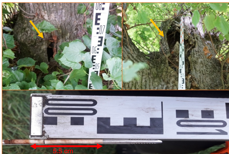
Foto 2: Overzicht ingerotte stamvoet en stam (oranje pijlen) van boomnummer 3 met resultaat boring door stam op circa 1 meter hoogte vanaf maaiveld (rode pijl).
