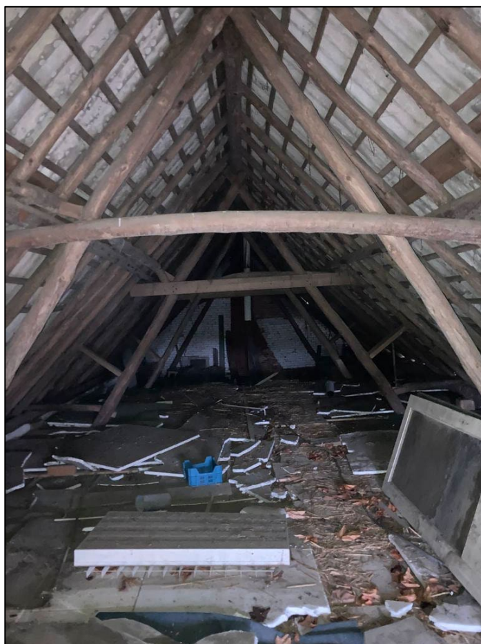
• Afbeelding 5: zolder ongeïsoleerd met asbest golfplaten
