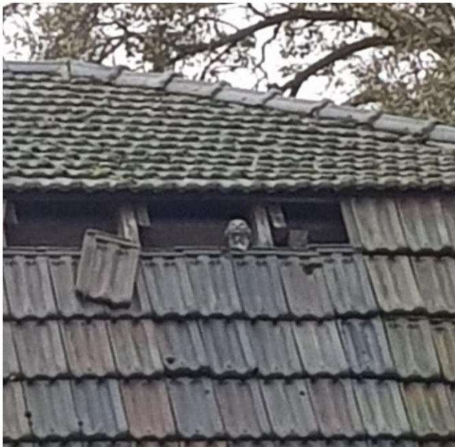
Figuur 4.4.1. Steenuil in de opening in het dak waar enkele dakpannen ontbreken, vastgelegd door een van de bewoners.
