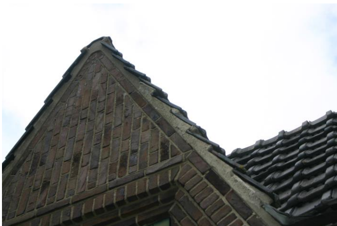
Figuur 4.4.4. De met specie afgestreken gevelpannen kieren op meerdere plaatsen, waardoor vleermuizen onder de dakpannen kunnen kruipen.
