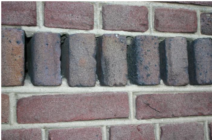
Figuur 4.4.3. De ventilatiesleuven bevatten een open stootvoeg achter elke baksteen en de sleuf is slechts 3 cm diep achter elke steen. Hierdoor zijnde ventilatiesleuven ongeschikt als vleermuizenverblijf.
