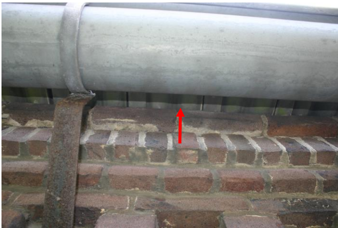
Figuur 4.4.5. De onderste rij dakpannen kieren met de gevel (rode pijl). Hierdoor kunnen vleermuizen de boerderij binnen. In het staldeel zijn echter geen vleermuisuitwerpselen of vleermuizen aanwezig.
