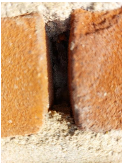
Figuur 4.2.2. De open stootvoegen in de zuidelijke gevel zijn opgevuld waardoor vleermuizen hier geen toegang hebben tot de spouw.
