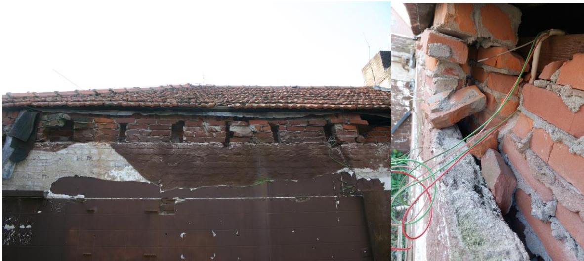
Figuur 4.2.3. De spouw in de noordgevel is dusdanig open dat deze te tochtig is voor vleermuizen.
