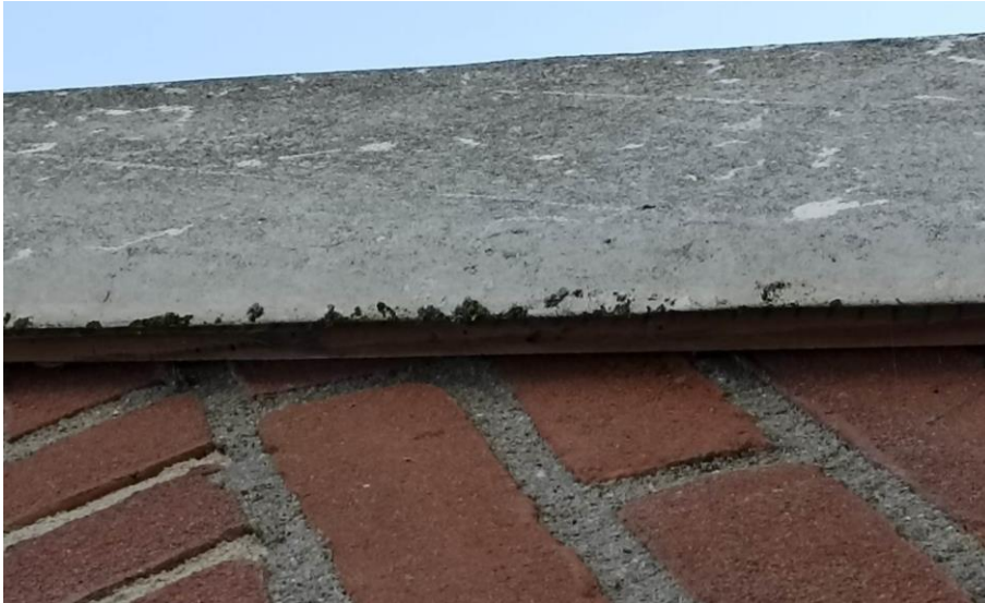
Figuur 4.2.5. Het onderste gedeelte van de windveer is op een houten lat strak tegen de gevel bevestigd waardoor vleermuizen hier geen toegang hebben.
