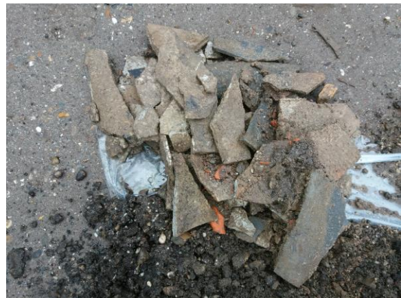
Asbestverdacht materiaal ABG4
