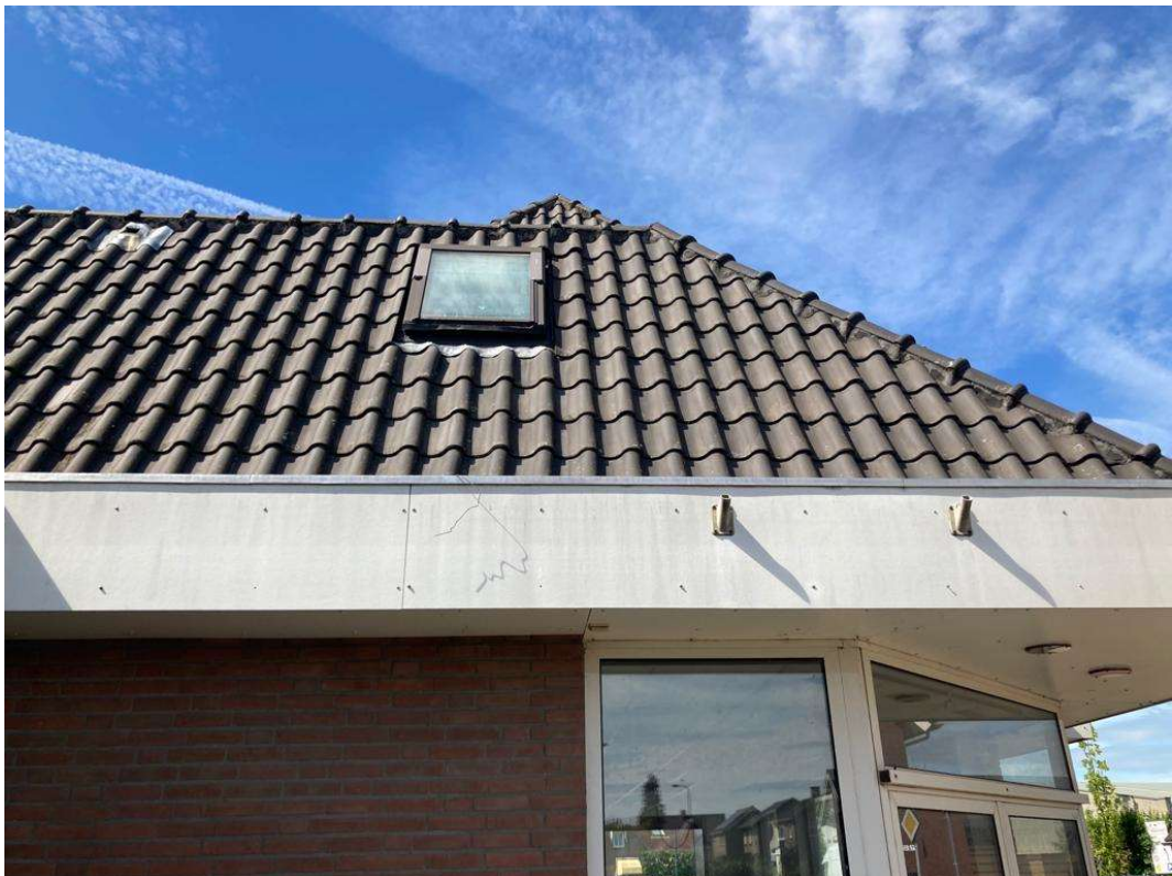
• Afbeelding 10: gevel nokpannen zijn alle dichtgesmeerd
