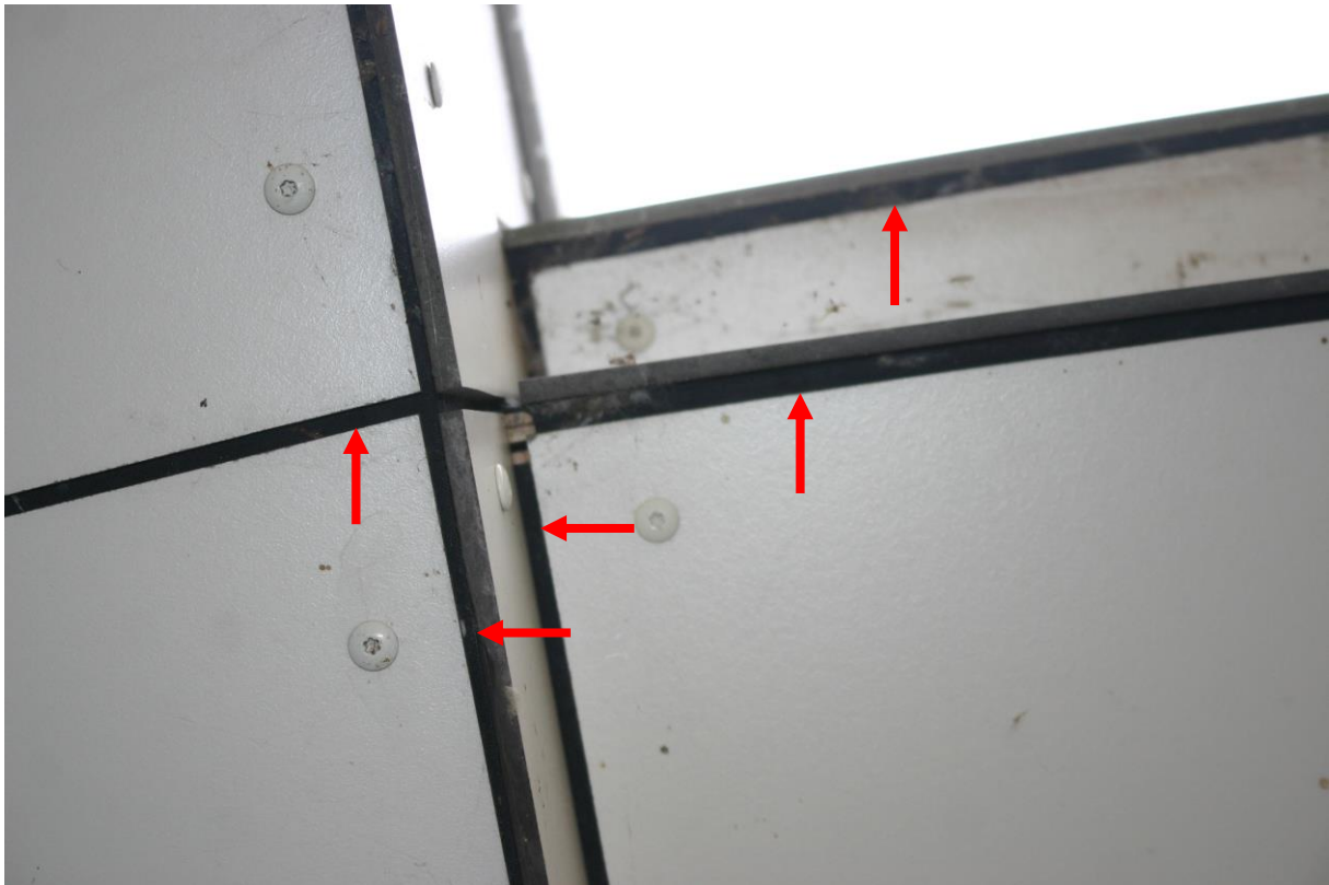
Figuur 4.4.1. De ruimtes tussen en onder de boeiboorden zijn dichtgemaakt met zwart schuim (rode pijlen). Hierdoor kunnen vleermuizen niet de betimmering in.
