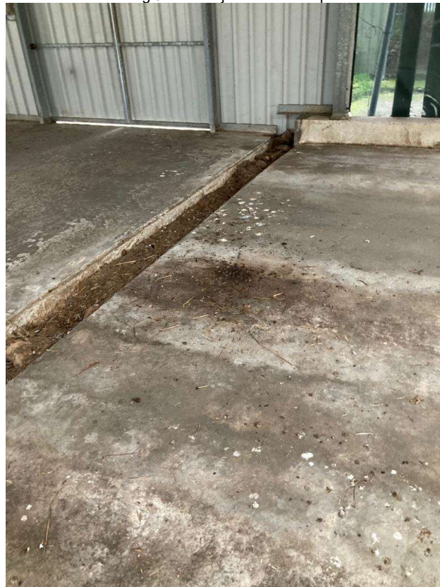
• Afbeelding 3: binnenzijde sheds met sporen van holenduiven
